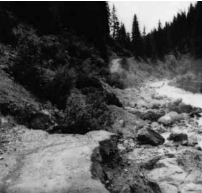
1987: Zerstörte Zufahrt südlich Lumbreiner Brücke. Fotos Konrad Sax-Lippuner.
